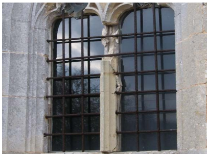
Oxydation du fer (Église de Sebecourt)
