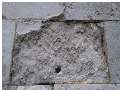
Desquamation et Pulvéulence (Église de Hauville)
